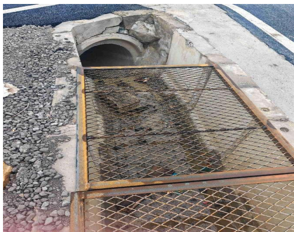
厂区内截排水沟
