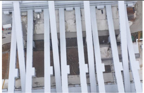
封闭的运输皮带系统
