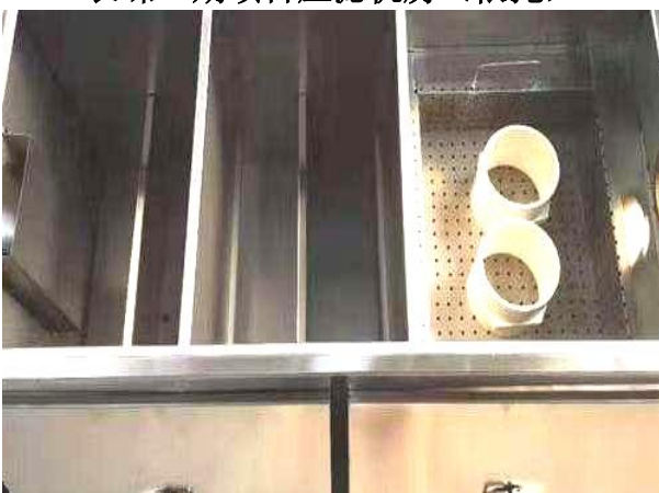
长峡一期项目隔油池（依托）
