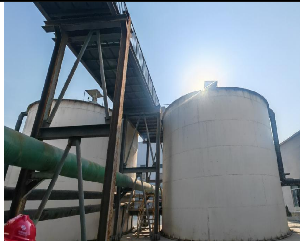
长峡一期项目泥罐（依托）
