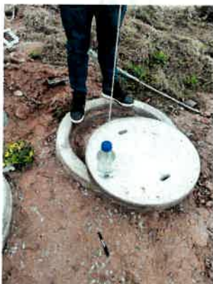
项目生活废水排口
